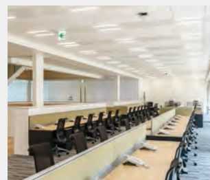
4F南側 PC作業・事務作業のしやすいフラットな光を創出する調光調色ベースライト
